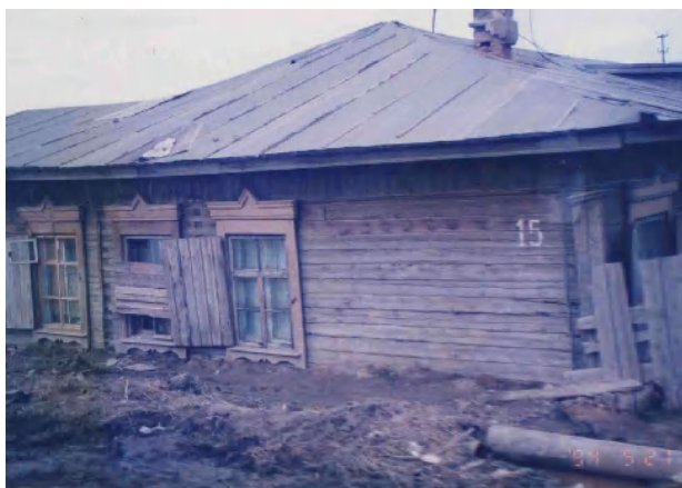
地中に沈み込んだ木造住宅
