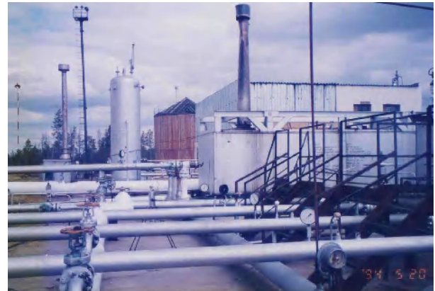
ガス精製設備
