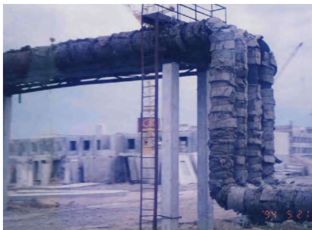
市中に伸びるパイプラインと保温
