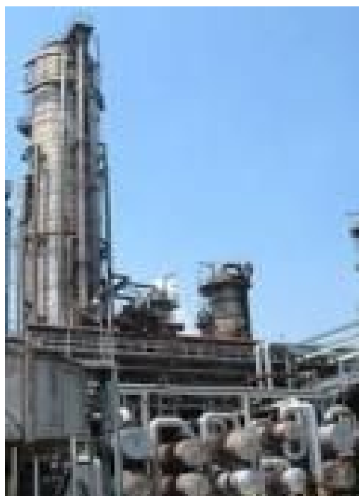
蒸留塔と熱交換器（右下）
