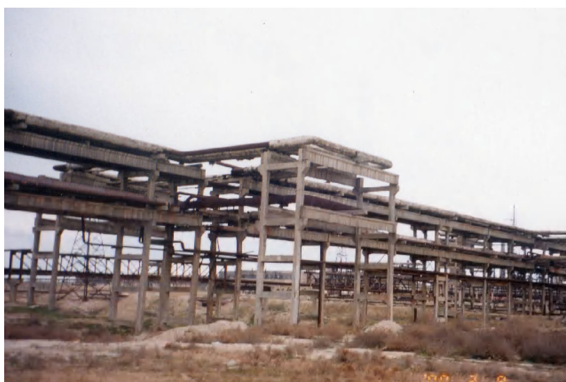
スムガイコンビナートのパイプラック
