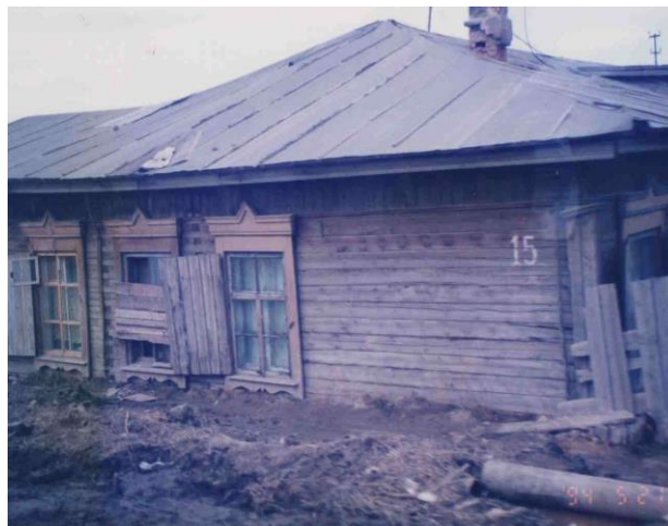
地中に沈み込んだ木造住宅
