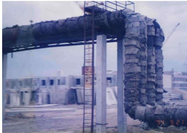
市中に伸びるパイプラインと保温
