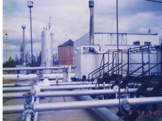
ガス精製設備
